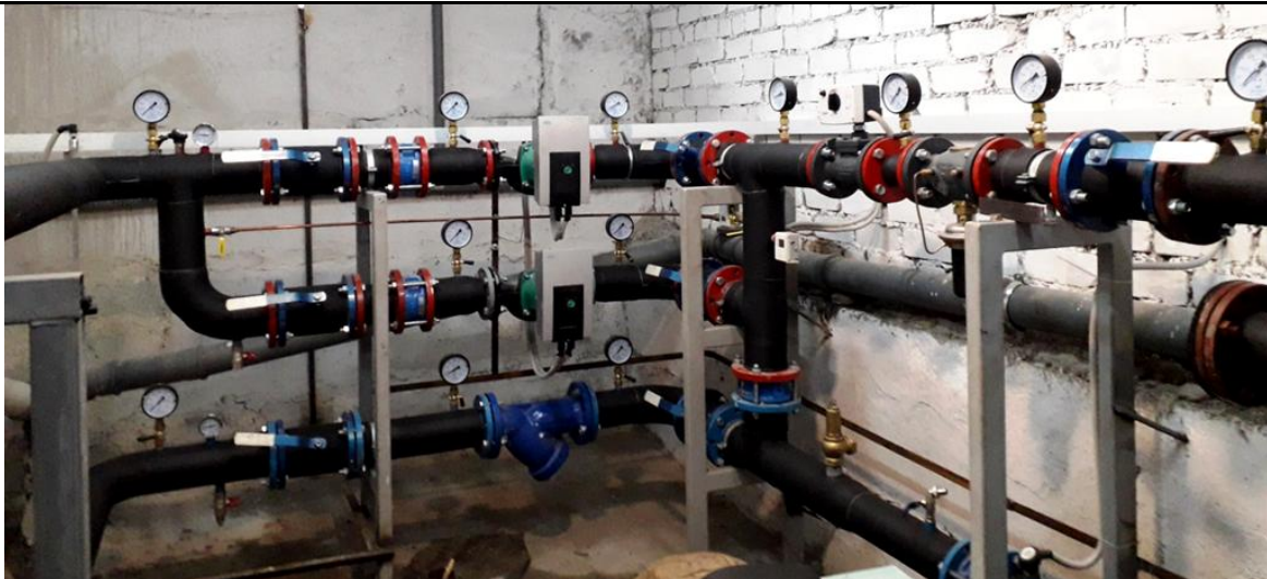
Индивидуальный тепловой пункт сейчас
